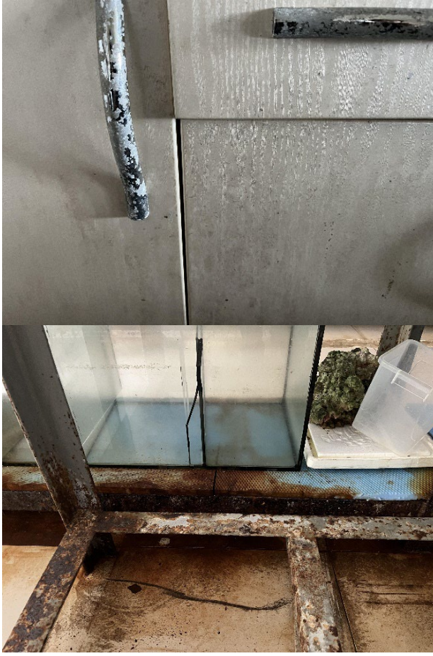
Şekil 3. Ahşap çürümesi, metal korozyonu (orijinal)
